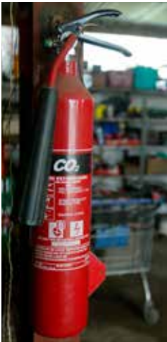
Los extintores de incendios deben estar al alcance de la mano.
