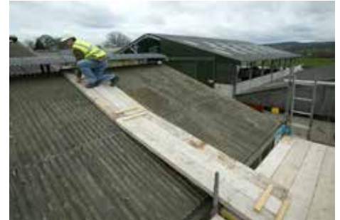
En las cubiertas frágiles, utilice tableros.
