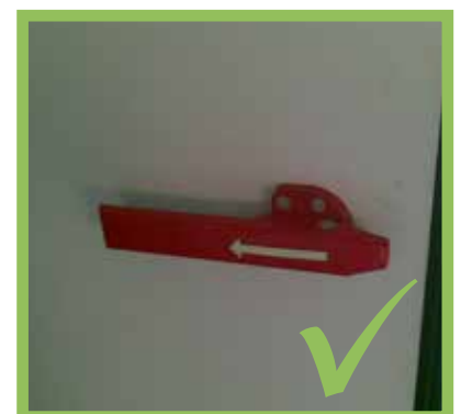
Salida fácil: instale tiradores de apertura en las cámaras frigoríficas.
